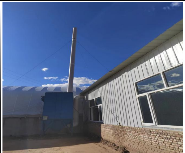
袋式除尘器+15米排气筒
