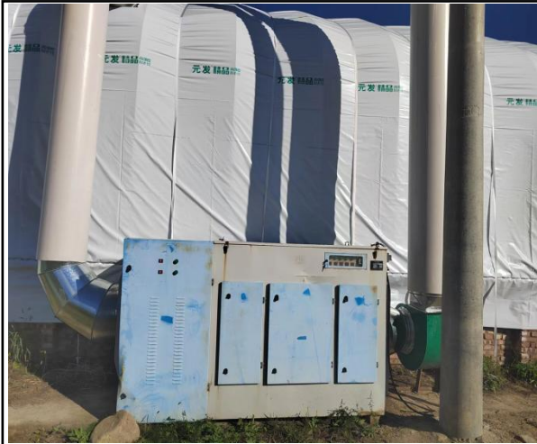
等离子光氧一体机+15米排气筒
